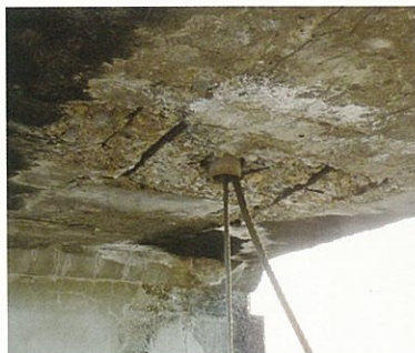
コンクリート表面剥離
