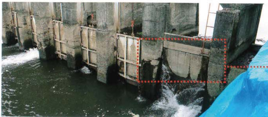
▲被害を受けた松の木堰
