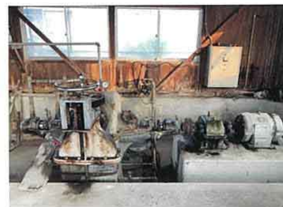
現在の揚水ポンプ（今年度改修予定）
